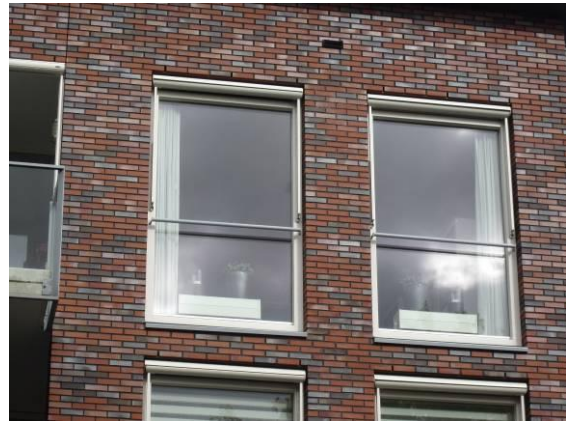
Ramen in de gevel welke niet geopend kunnen worden
