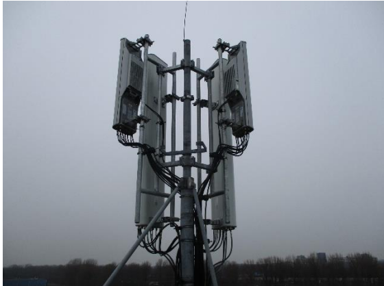
GSM antennemast aangetroffen
