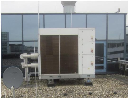
Luchtbehandeling en airco-units aangetroffen
