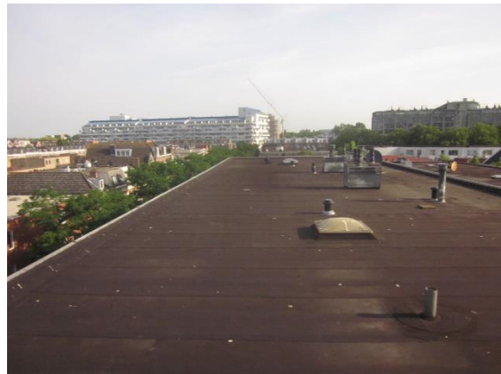
Doorvalgevaar door een lichtkoepel
