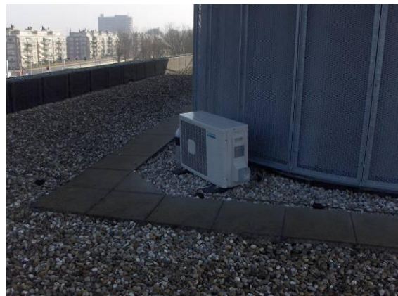
Airco-installatie op het dakvlak
