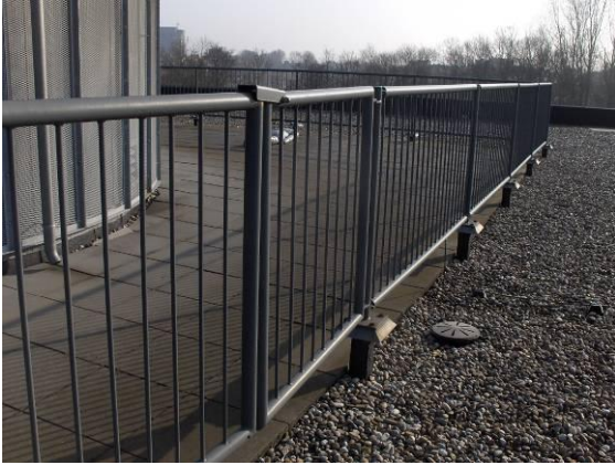
Onveilige toetreding tot het dakvlak binnen 4 meter van de dakrand
