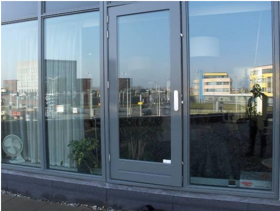
Veilige toetreding tot het dakvlak via een deur van binnen uit het gebouw
