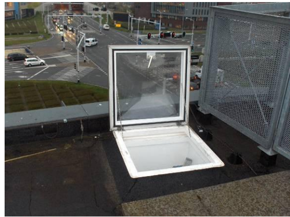
De lichtkoepel bevindt zich binnen 2 meter van de dakrand en is niet geborgd tegen dichtvallen
