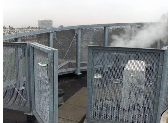
Toetreding tot de installaties via een deur in het hekwerk
