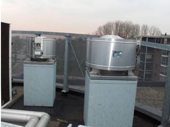
Diverse installaties in het met hekwerk omringde dakdeel
