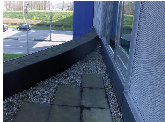
Onveilige toetreding tot het dakvlak via een deur binnen 2 meter van de dakrand
