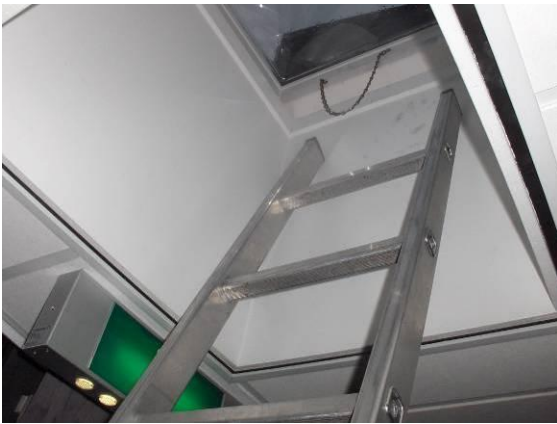
De mobiele ladder kan niet geborgd worden bij toetreding tot het dakvlak
